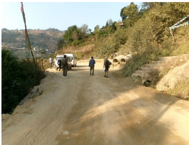
写真 LS2 19km 地点地すべりを通過する道路の現在（人のいる付近から奥側、トウモロコシ畑手前までが地すべり地通過区間）（2024.11.25）
