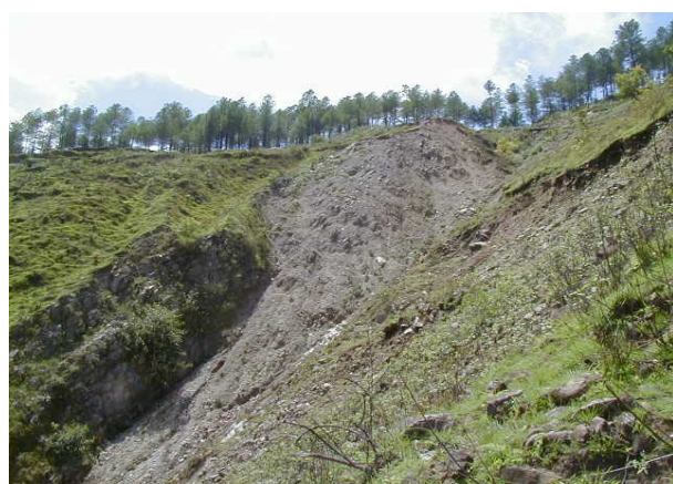
写真 Dh2 試験施工前の地すべり斜面起源の崩壊発生状況 (2001 年 6 月)
