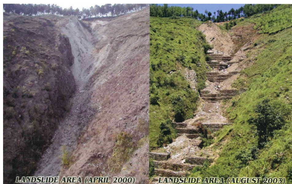
図 Dh2 沢源頭部の崩壊・地すべり箇所（左：2000 年）と砂防堰堤及びバイオエンジニアリング施工後（右：2003 年）（DMSP, 2004）
