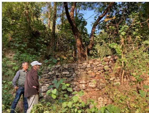
写真 P8 同上の現在の状況（鉄線の腐食や サイド部分の一部洗堀はあるが堆砂し、背 後の崩壊土砂を止めている。（2024 年 11 月）
