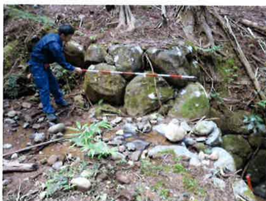
堰堤の左岸袖
