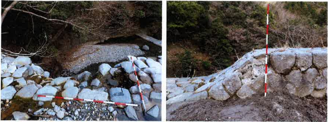
本堰堤の石材欠落状況（左：水通し部，右：右岸の水通し袖部立ち上がり）
