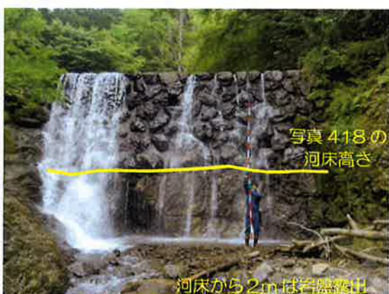
堰堤正面 河床低下状況 (平成28年6月1日撮影)
