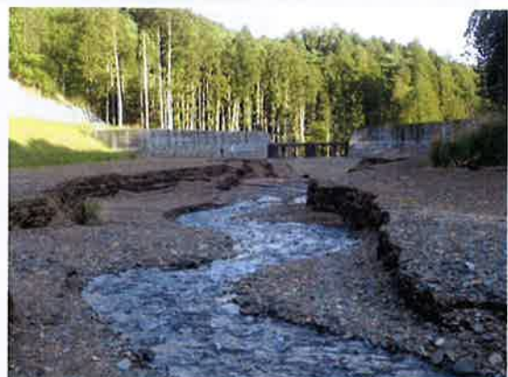
堆砂敷から土砂が流出している (平成 28 年 5 月 20 日撮影)
