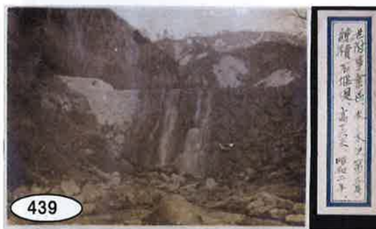
水ノ木沢第3号 練石積堰堤 （昭和2年撮影） [諸戸北郎博士アルバム]
