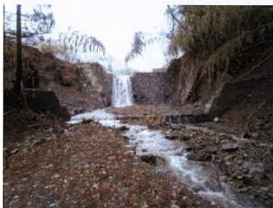
山口堰堤災害復旧前状況 (平成 22 年撮影) [静岡県砂防課提供]
