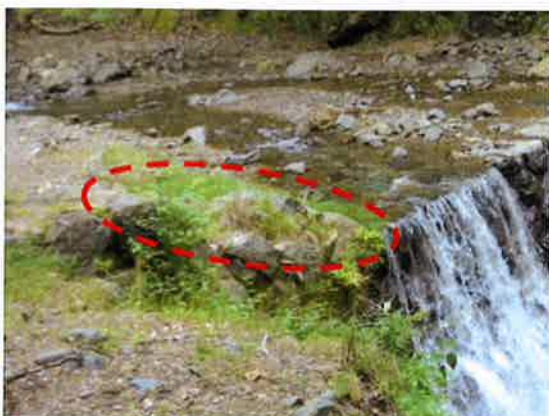
右岸袖部 石積欠損 (平成28年6月1日撮影)
