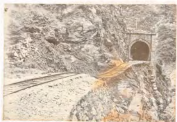
板元隧道入口破壊
