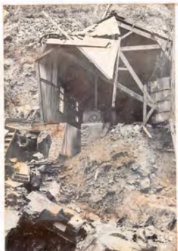
第三隧道の入口の破壊
