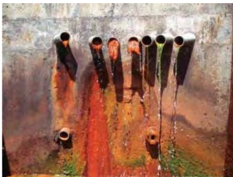
集水孔口がスライムにより閉塞
