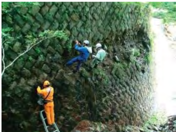
練石積堰堤下流法面の損傷 （内部は粗石コンクリート）
