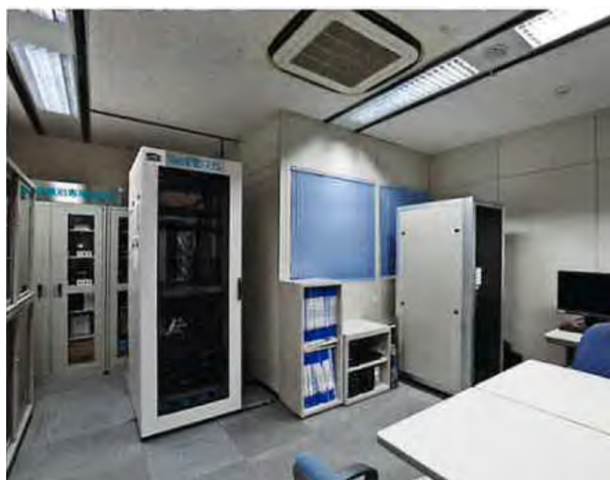
Sabo D-MaC専用オペレーション室
