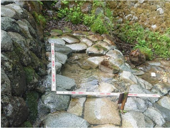
図-2 石張欠損状況（令和2年4月）
