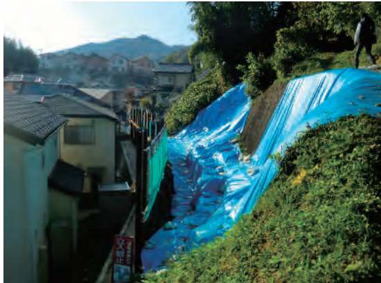
山本地区 かけ崩れ発生箇所
