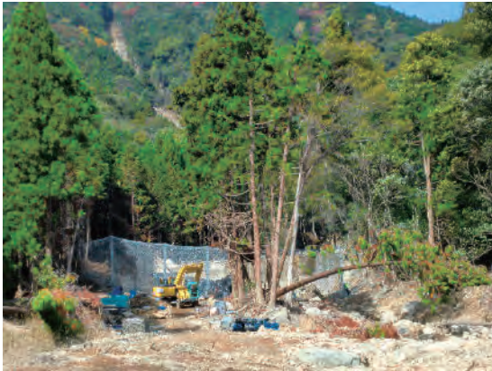
八木4丁目の応急対策状況
