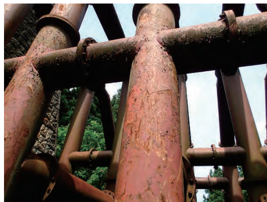
前谷川鋼製堰堤 土石流の衝突痕
