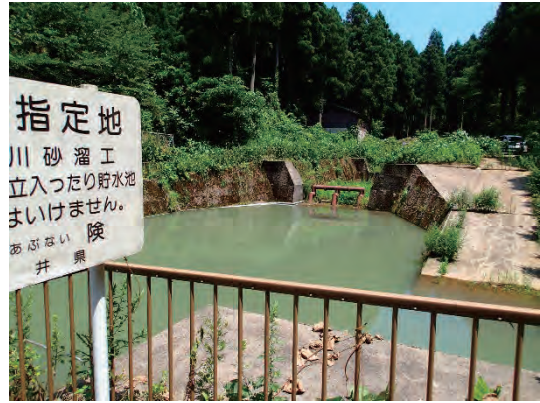
神宮川 沈砂池
