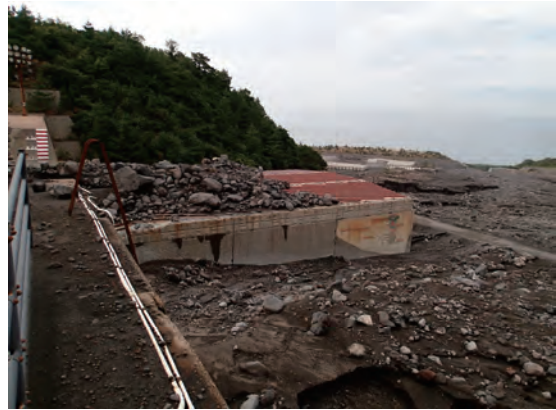
野尻川 底面スクリーンダム
