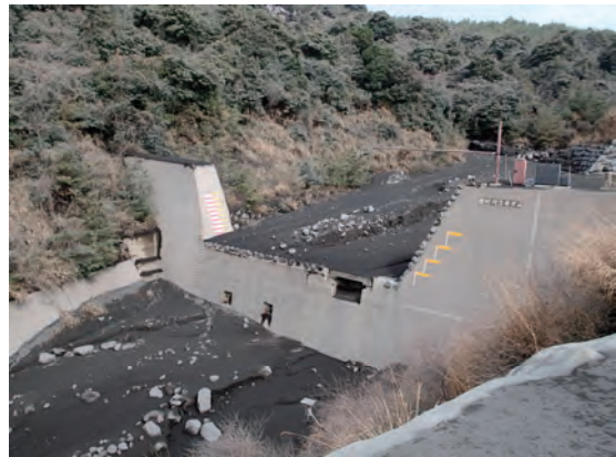
有村川 3号堰堤 水通し部の左岸側には土石流荷重センサー
