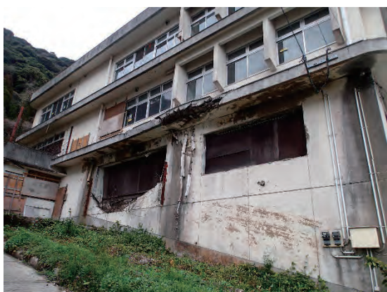
花倉地区 被災した病院跡
