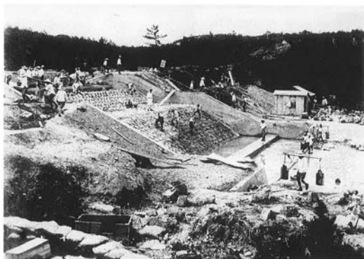
写真1 土堰堤施工状況（昭和8年 名古屋市守山区） ※「出役人夫60人」とある
