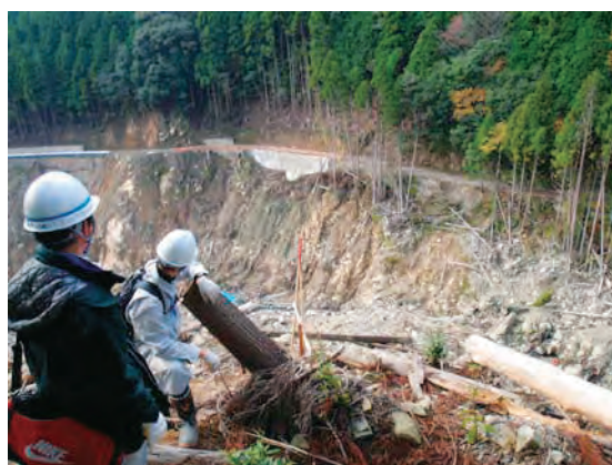
林道の被災状況
