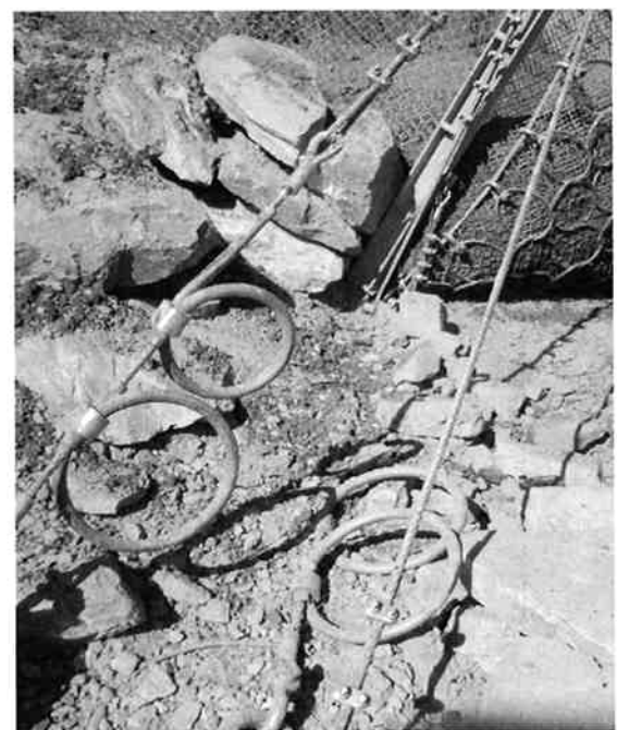
写真-3 ブレーキリングの状況 Photo 3 Deformation of brake rings
