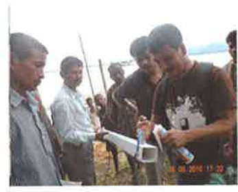
水位計（結線部をコーキング）
