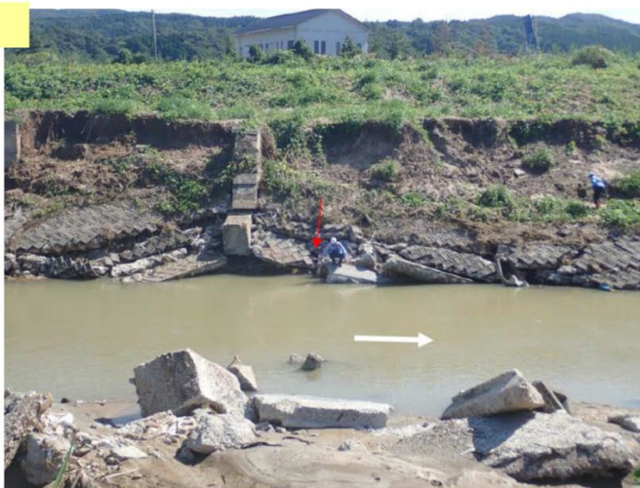
地震で隆起(3.5m)した場所で護岸が損傷
