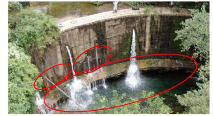
堰堤基礎の大きな洗掘や広範囲の漏水
